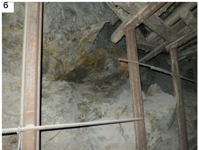
Рис. 3. Обрушение на правой стенке (а) и на кровле горных выработок (б)
